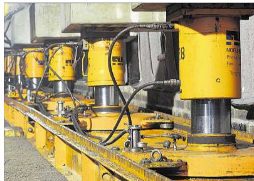
DIESE „STEMPEL“ heben das Bauteil empor. Gleichzeitig rutschen sie damit auf den Verschiebbahnen der Zielposition entgegen.
